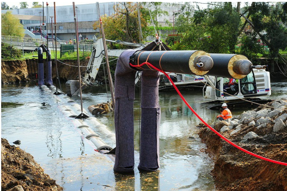
Lors des travaux d'extension du réseau de chaleur, la pose de tuyaux dans le lit de l'Huisne. © Ville du Mans
