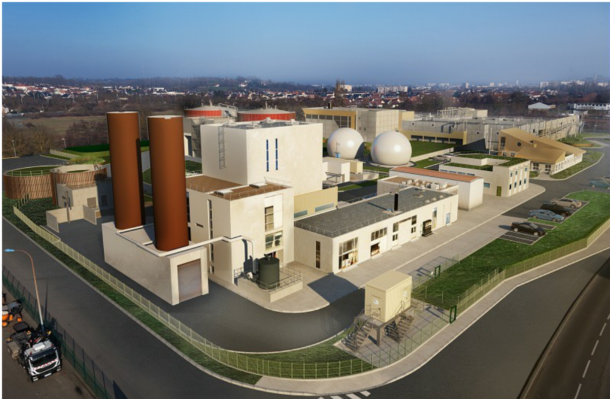
La future unité de méthanisation des boues d'épuration, en cours de construction sur le site de La Chauvinière. © Veolia
